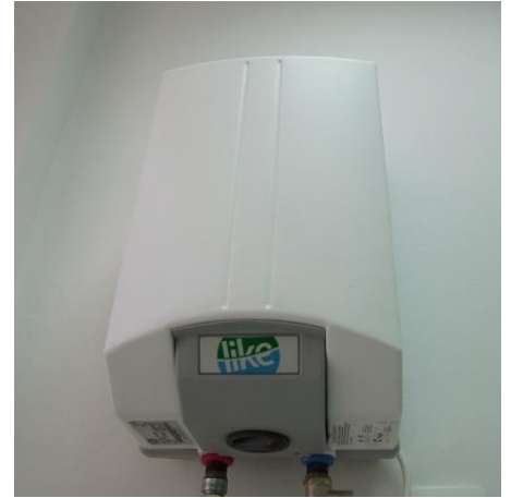
Slika 6: Lokalni električni grelniki vode
