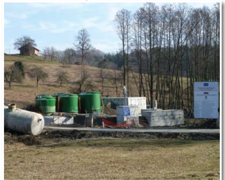
Čistilna naprava ob Andreškem potoku
