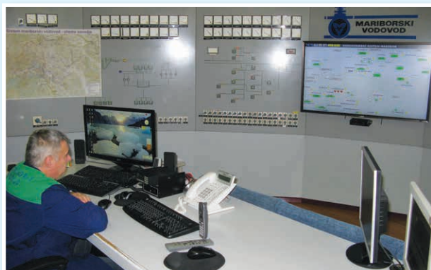
Center nadzora in vodenja vodooskrbnega sistem Mariborskega vodovoda
