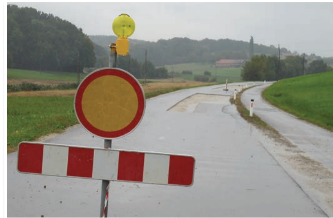
Na varnost v cestnem prometu vpliva tudi redno vzdrževanje cest.
