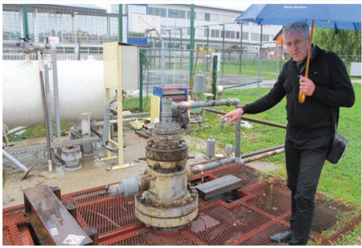
Župan Milan Gumzar pred rekonstruirano vrtino, ki daje energijo za ogrevanje šole, telovadnice in občinske zgradbe
