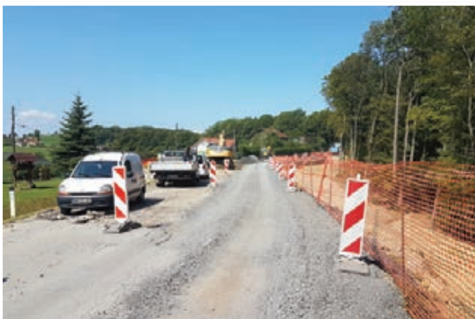
Sanacija plazu v Zg. Partinju
