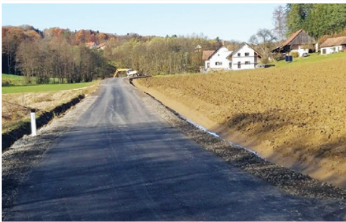
V Občini Benedikt so modernizirali cesto Drvanja-Bačkova-Froleh na ruralnem območju, saj si prizadevajo za enakomeren razvoj občine kot celote. Foto: arhiv Občine Benedikt
