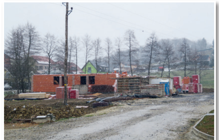
Kljub epidemiji nevarnega virusa v naselju B 15 v občini Benedikt raste novi stolpič z dvanajstimi stanovanji, ki bo v kraj in občino pritegnil nove prebivalce, zlasti mlajše.
