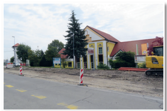
V Cerkevniku, kjer so lani modernizirali regionalno cesto skozi naselje, bodo naslednje leto še energetska sanirali zgradbo osnovne šole v središču naselja, ki so jo zgradili leta 1967, dogradili pa leta 1987 in 1999.
