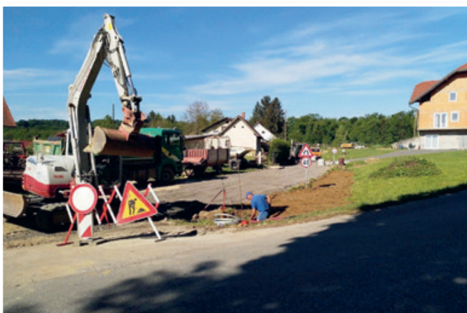
Kanalizacija v Lormanju
